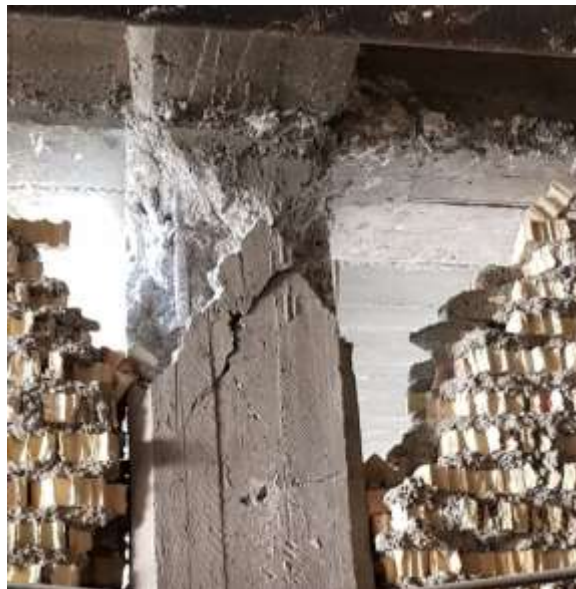
شکل ۷- تخریب بتن یکی از ستون‌های ساختمان بیمارستان شهدا در سرپل ذهاب
