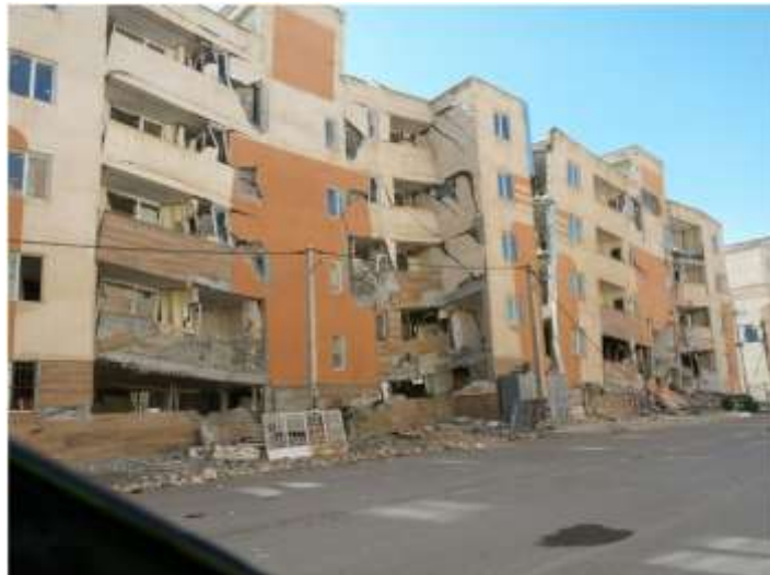
شکل ۸- تخریب دو بلوک بتنی در مجموعه مسکن مهر شرف آباد در اسلام‌آباد غرب
