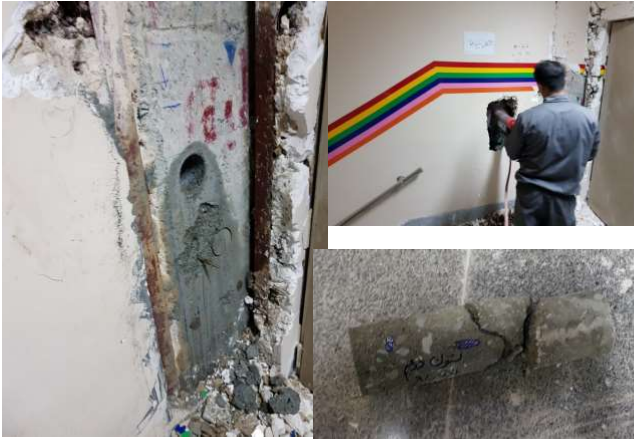
شکل ۵- عدم امکان اخذ مغزه سالم از ستون‌ها و دیوارهای برشی آسیب دیده در ساختمان جدید الاحداث بیمارستان امام خمینی (ره) در اسلام آباد غرب
