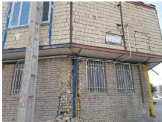
شکل ۱۲- ساختمان سالم مانده در اسلام آباد بدون سیستم سازه‌ای استاندارد
