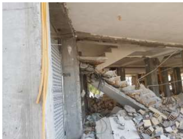
شکل ۲۰- ساختمان بتنی نوساز با تخریب شدید راه پله و عناصر غیر سازه‌ای در سرپل ذهاب
