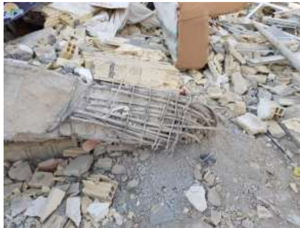
شکل ۱۹- آرماتورهای یکی از ستون‌های ساختمان بتنی نوساز فروریخته در سرپل ذهاب
