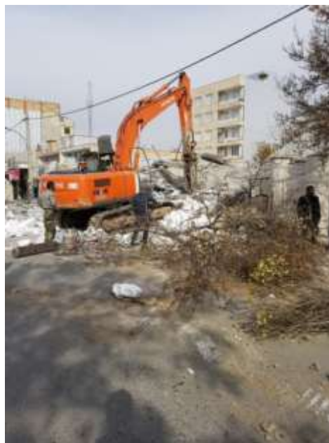
شکل ۱۴- ساختمان بتنی نیمه‌کاره فرو ریخته در اسلام آباد (ب)
