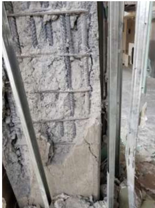
شکل ۳- گسیختگی بتن در یکی از ستون‌های طبقه پنجم ساختمان جدید الاحداث بیمارستان امام خمینی (ره) در اسلام آباد غرب
