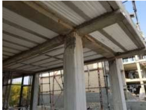
شکل ۱۷- ساختمان بتنی آسیب دیده در حال ساخت در سرپل ذهاب (ب)
