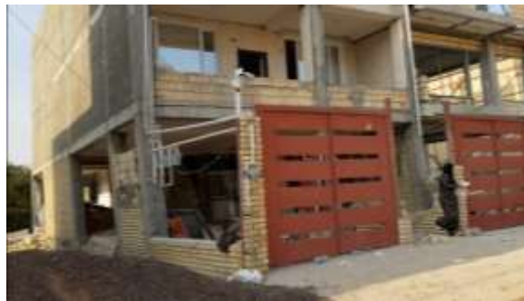
شکل ۱۶- ساختمان بتنی آسیب دیده در سرپل ذهاب (الف)
