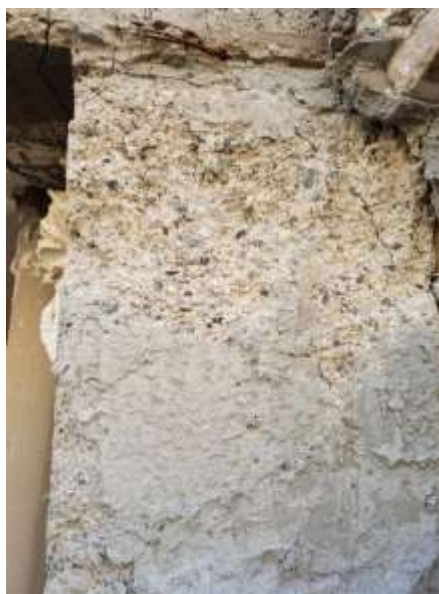
شکل ۹- ستون گسیخته شده در یکی ساختمان‌های اسکلت بتنی در مجموعه مسکن مهر شرف آباد در اسلام‌آباد غرب
